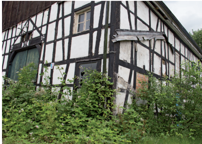
Sichtbar fällt das Fachwerkhaus mehr und mehr auseinander.
